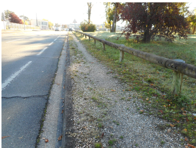
C10 Revêtement de trottoir inconfortable
