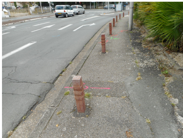
M5 Abaque non conforme
