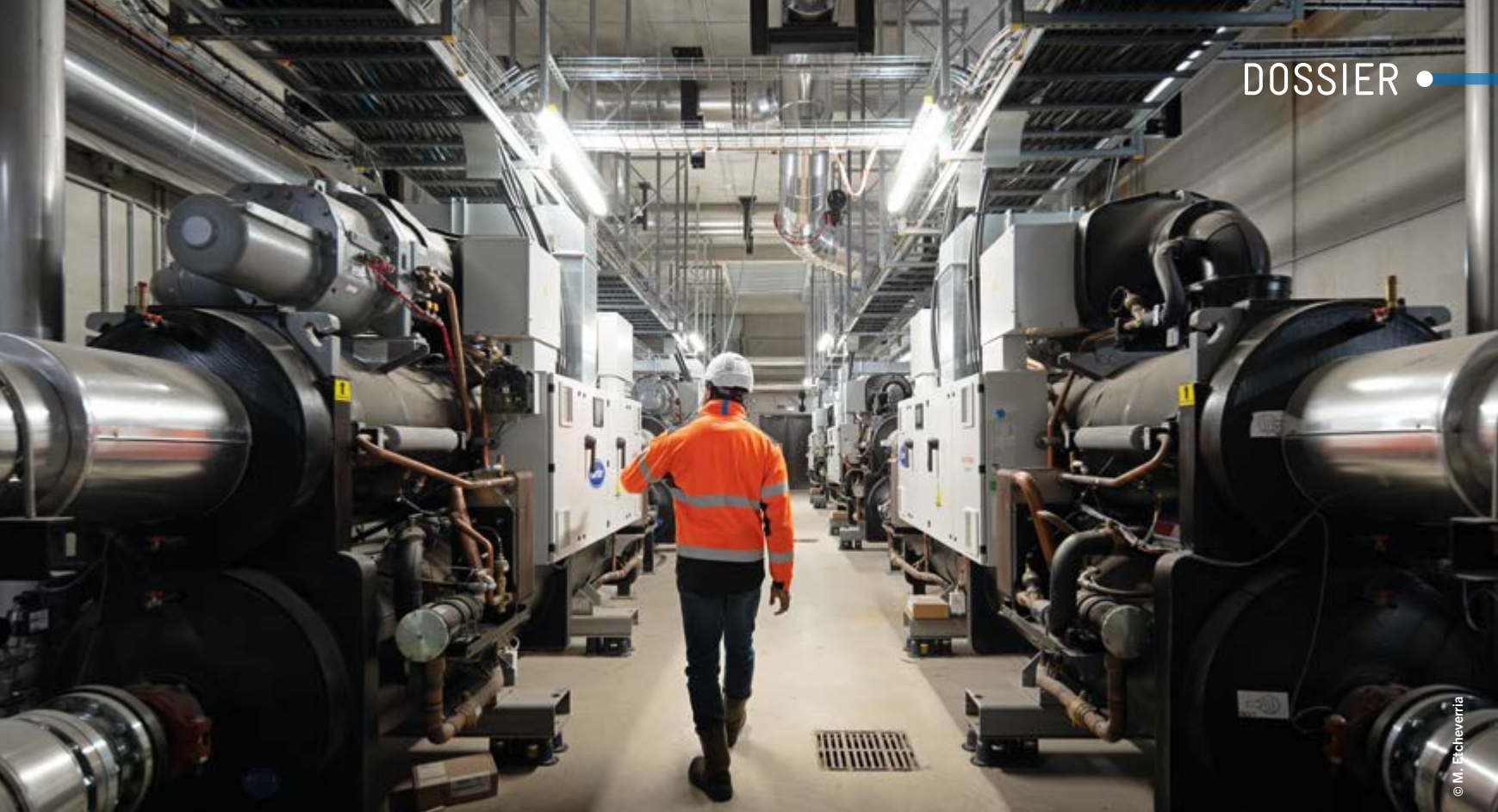
Réseau de chaleur Plaine de Garonne Énergie
