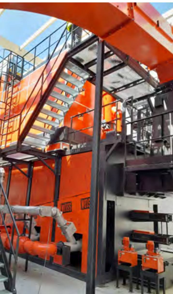
Chaudière biomasse Plaine de Garonne Energies. Source : Dylan Masclaux - Bordeaux Métropole
