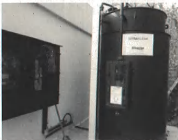
PHOTOGRAPHIE 3 - SOC.2.2 Cuve de stockage
