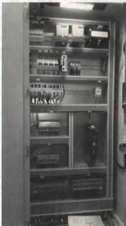
PHOTOGRAPHIE 1 - PAT.3.7 Automatisme pompes à boues Louis Fargue
