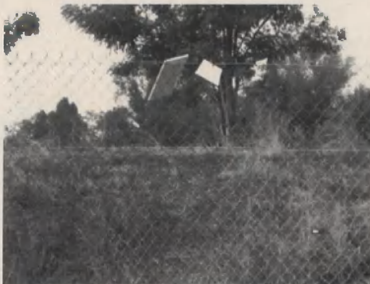
PHOTOGRAPHIE 2 - EXPL.8.2 Panneau cassé au bassin de Béquigneaux
