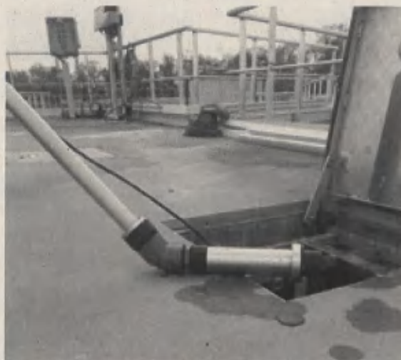
PHOTOGRAPHIE 2 - ENRG.2.2 Transmetteur NH4 - Régulation de l'aération des bassins biologique de Lille Blanquefort
