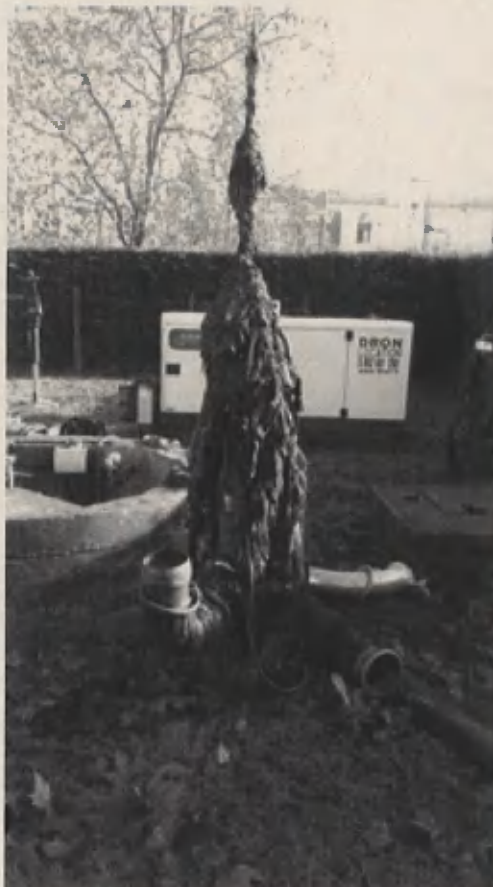
PHOTOGRAPHIE 9 - EXPL.8.1 Pompe du poste des Aubiers avec des amas de matière
