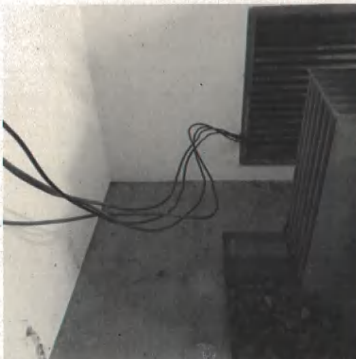
PHOTOGRAPHIE 8 - EXPL.8.1 Connection électrique non autorisée à Blanquefort ZI en décembre
