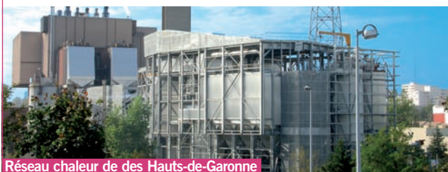
Réseau chaleur de des Hauts-de-Garonne
